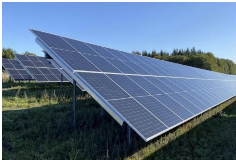
Figur 3-7. Foto af række med Fixed-tilt opstilling. Kilde: Ecosolar.
